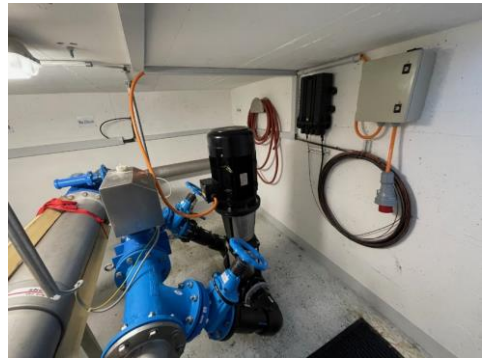
Notversorgungspumpe Schacht Zollhaus
